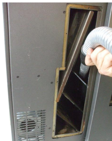
Fig. 45 - Pulizia camera fumi
