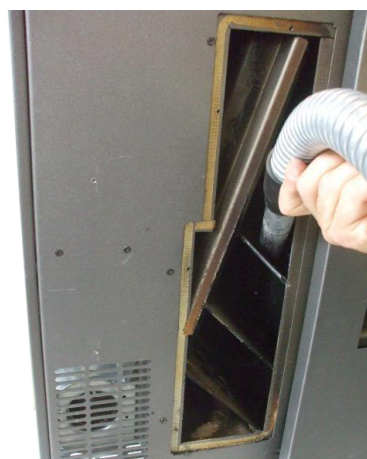
Fig. 44 - Pulizia camera fumi
