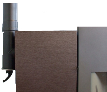
Fig. 45 - Pulizia canale da fumo
