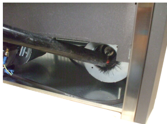
Fig. 56 - Limpeza do ventilador ambiente
