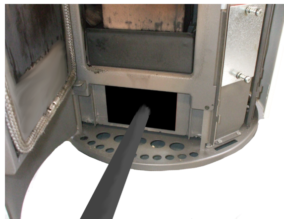
Fig. 41 - Pulizia camera fumi
