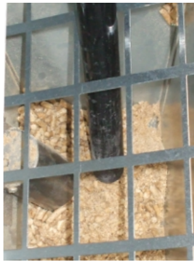
Fig. 39 - Pulizia serbatoio e coclea
