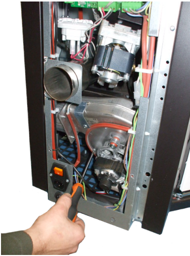
Fig. 84 - Limpeza do aspirador de fumos: fase 1
