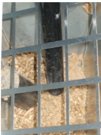
Fig. 31 - Pulizia serbatoio e coclea
