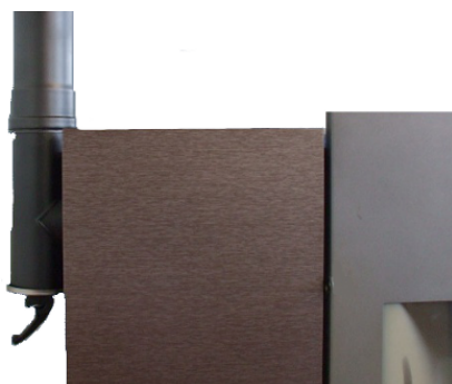
Fig. 45 - Fume conduit cleaning
