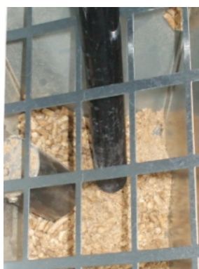
Fig. 40 - Reiniging van de voorraadbak en transportschroef
