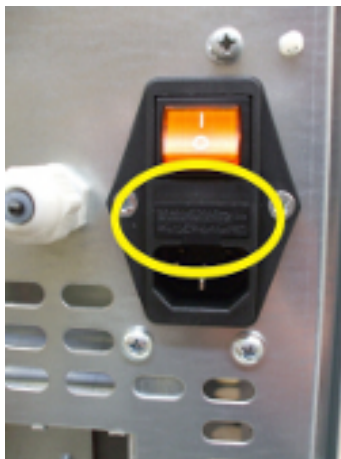
Fig. 62 - Hublot avec les fusibles à enlever
