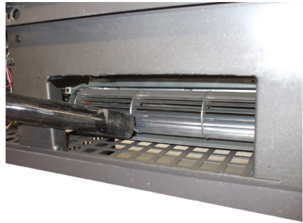
Fig. 47 - Καθαρισμός ανεμιστήρα δωματίου
