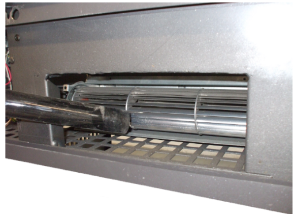
Fig. 47 - Limpeza do ventilador ambiente
