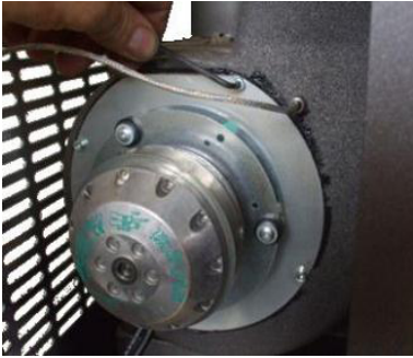
Fig. 40 - Limpeza do aspirador de fumos: fase 1
