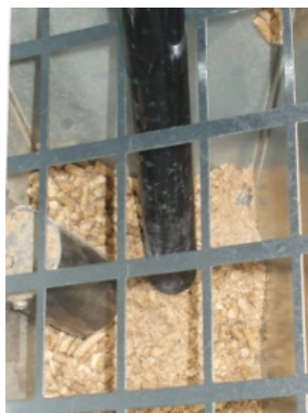
Fig. 36 - Limpieza depósito y coclea
