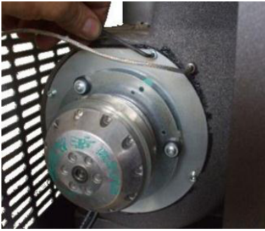
Fig. 40 - Limpieza del aspirador de humos: fase 1
