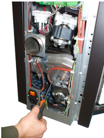
Fig. 84 - Pulizia aspiratore fumi: fase 1
