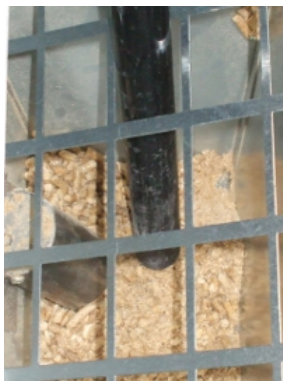
Fig. 60 - Pulizia serbatoio e coclea
