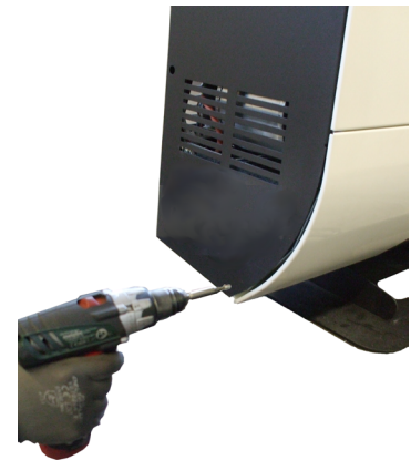
Fig. 22 - Fixação inferior dos painéis
