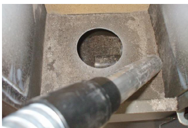
Fig. 39 - Limpieza alojamiento cajón de cenizas
