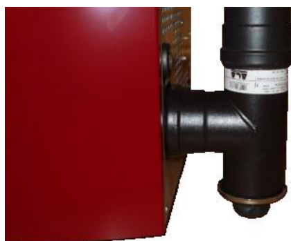
Fig. 39 - Fume conduit cleaning
