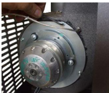
Fig. 37 - Pulizia aspiratore fumi: fase 1
