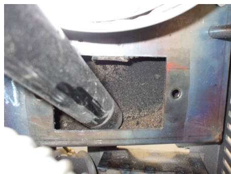
Fig. 35 - Pulizia camera fumi
