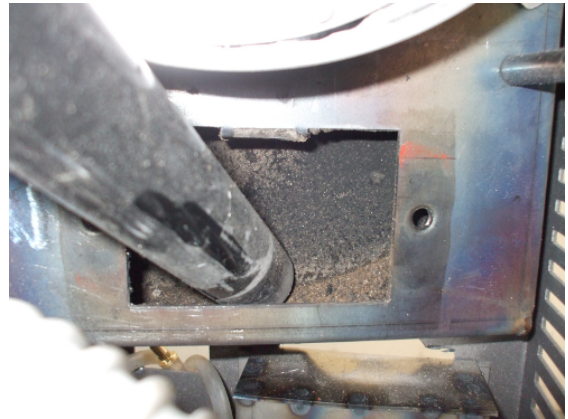
Fig. 35 - Καθαρισμός θαλάμου καυσαερίων
