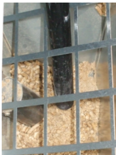
Fig. 29 - Pulizia serbatoio e coclea
