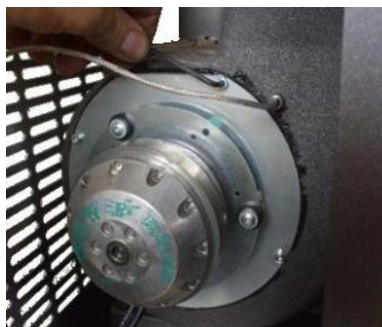
Fig. 33 - Pulizia aspiratore fumi: fase 1
