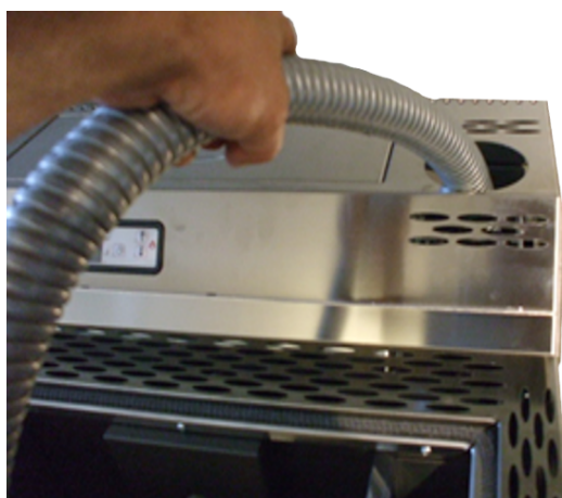
Fig. 30 - Pulizia canale da fumo
