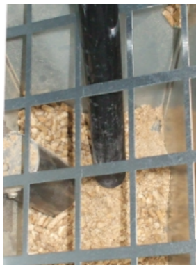
Fig. 26 - Pulizia serbatoio e coclea
