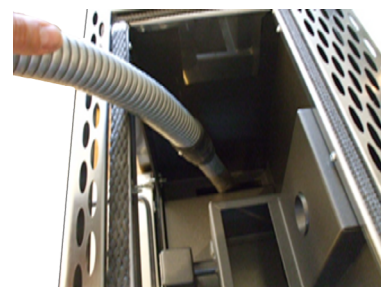
Fig. 23 - Reiniging van de verbrandingskamer
