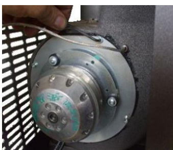
Fig. 40 - Pulizia aspiratore fumi: fase 1
