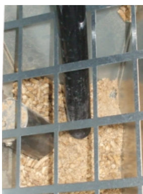
Fig. 36 - Pulizia serbatoio e coclea
