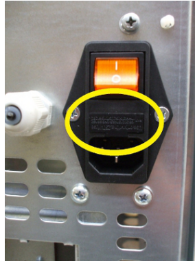
Fig. 48 - Trappe avec les fusibles à changer
