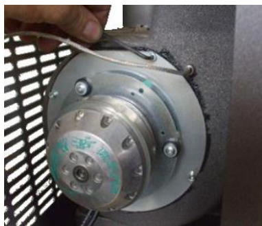
Fig. 32 - Pulizia aspiratore fumi: fase 1
