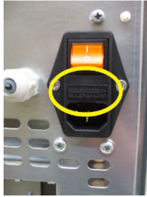
Fig. 35 - Hublot avec les fusibles à enlever
