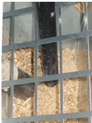
Fig. 47 - Reiniging van de voorraadbak en transportschroef
