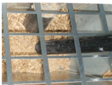
Fig. 47 - Pulizia serbatoio e coclea
