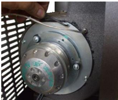
Fig. 50 - Pulizia aspiratore fumi: fase 1
