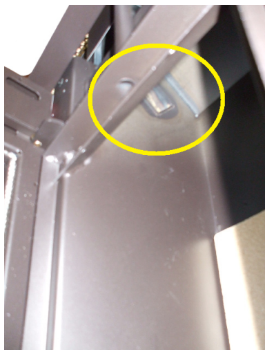
Fig. 76 - Passage van de rookgassen
