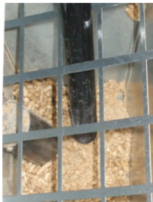
Fig. 60 - Reiniging van de voorraadbak en transportschroef
